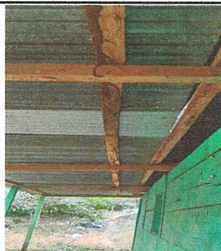
Foto 4: Estructura de madera con visible deterioro.
